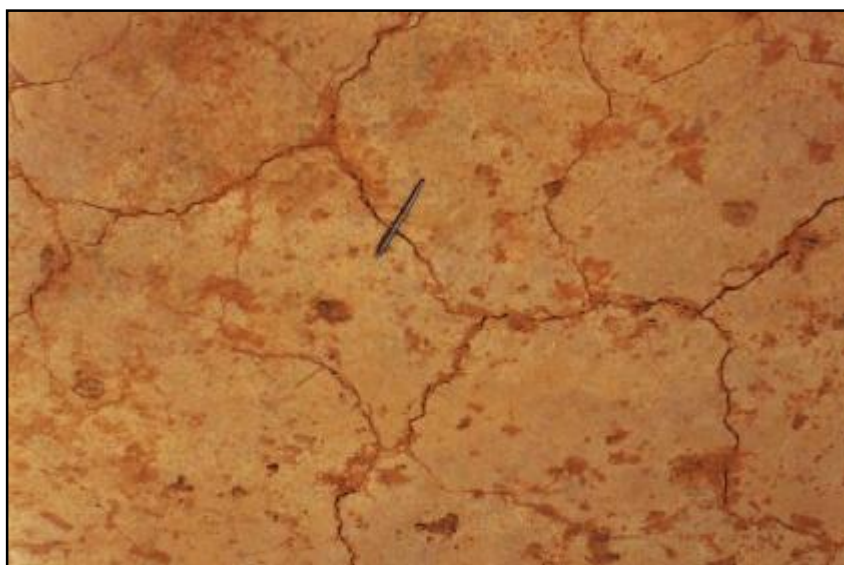
Aspecto das trincas superficiais de retração que ocorrem sobre camada de solo tratado
